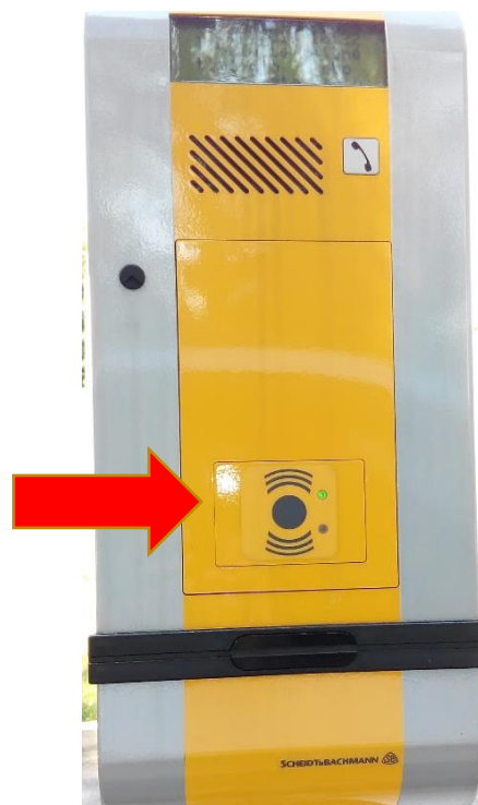
Vjazdový a výjazdový terminál na parkovisku Univerzitný vedecký park UNIZA a Výskumné centrum
